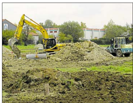
Im neuen Baugebiet an der Sachsenstraße in Beckum laufen die Erschließungsarbeiten nach Plan. Bild: Krogmeier
